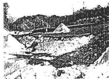
(ごみ焼却灰処分場)
