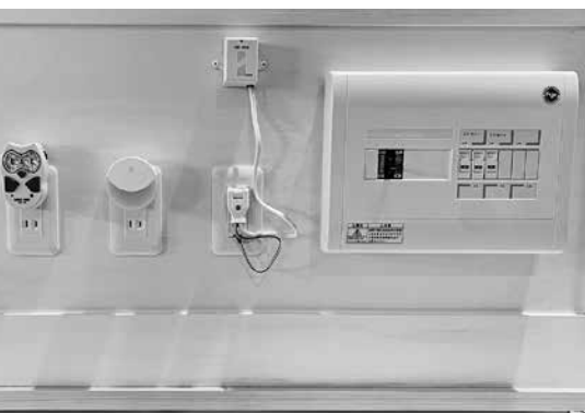
▲感震ブレーカーの設置例 (防災ポラ提供)
